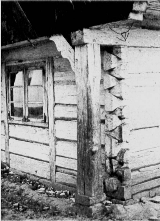
Altes Bauernhaus in Friedrichsdorf bei Gr.-Engelau Vollholzbau, waagerechte, an den Ecken verzahnte Stämme, Satteldach und Krüppelwalm
